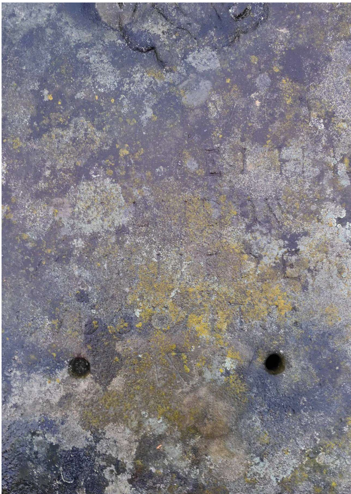
Fot. nr 3. Hażlach, cmentarz parafialny przy ul. Kościelnej, płyta nagrobna rodziny Bludowskich. Widok z góry - fragment. Stan przed konserwacją. Widoczne: nieczytelny napis na płycie, mocne zabrudzenia obiektu, zniszczenia powstałe w wyniku tzw. korozji biologicznej – grzybów, mchów i porostów.
